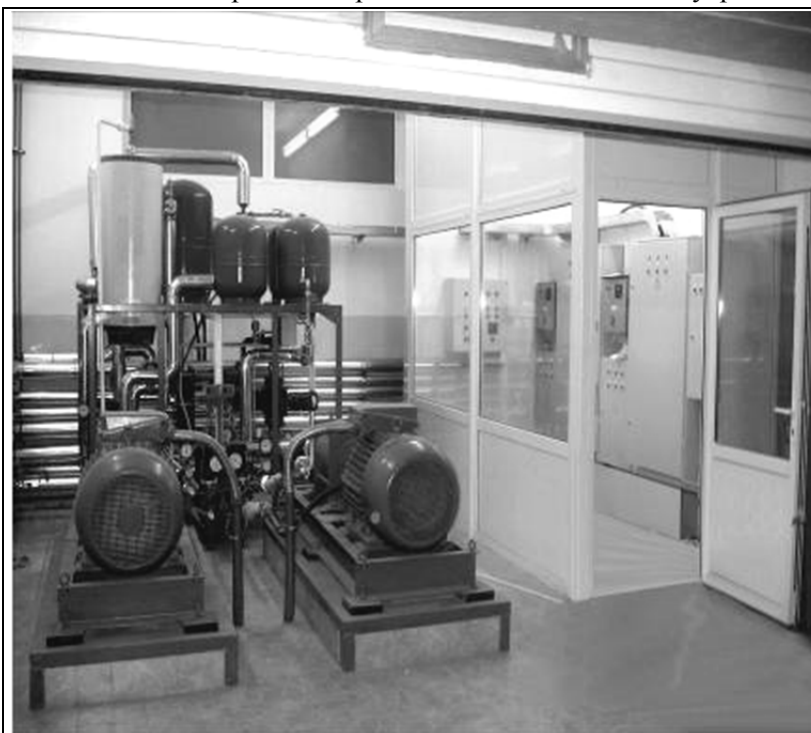
Рис. 3. Общий вид теплопункта производительностью 150 кВт.
